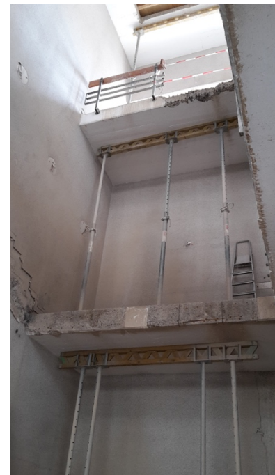
Bild 4 abgebrochenes mittleres Treppenhaus
